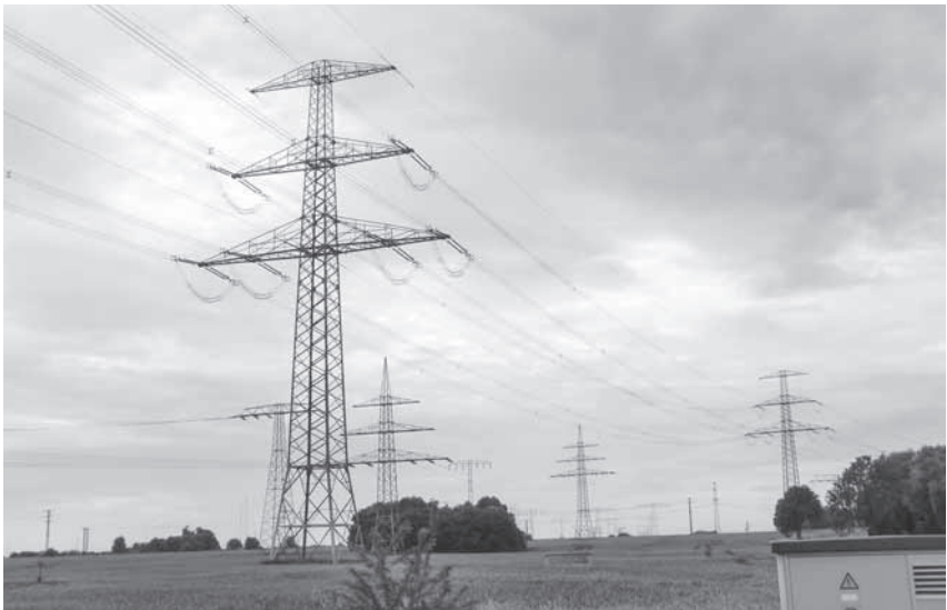
Abb. 5: Konzentration von 380 und 220 kV-Leitungen bei Löbschütz südlich von Leipzig (Quelle: RPV Leipzig-West Sachsen)
